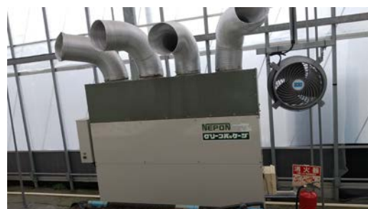
ヒートポンプ
